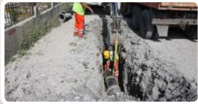
▶ ADNAN KAHVECİ MAHALLESİ BESİM SOKAK YAĞMUR SUYU KANAL YAPIMI • FEN İŞLERİ MD.
