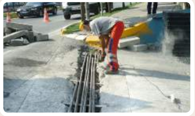
► TÜZE SİTESİ GARAJ GİRİŞİ PATLAK SU TAMİRİ • FEN İŞLERİ MD.
