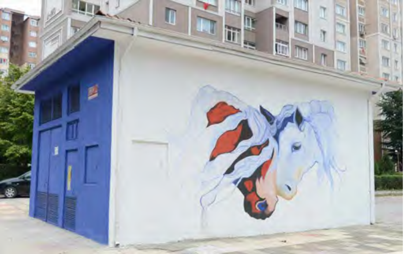
Çamlık Caddesi Üzeri trafo süsleme
